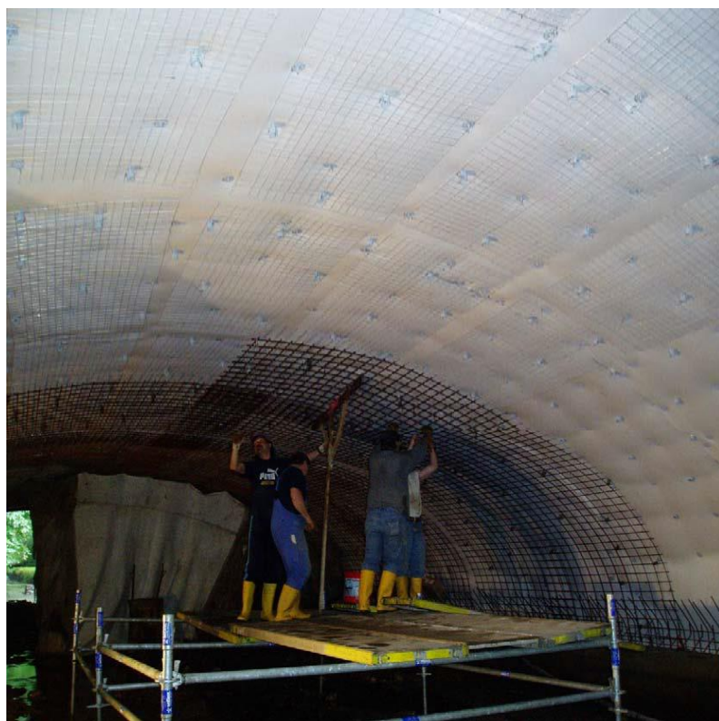
Silver Seal membrana u sanaciji tunela u Bad Elsteru
